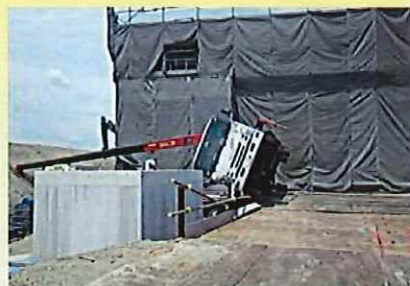
移動式クレーン転倒状況
