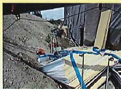
資材散乱状況
